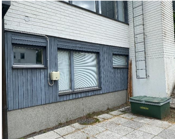
Kuva 20. Julkisivulaudoituksen maalipinta on kulunut ja julkisivulaudat monin paikoin haristuneet
