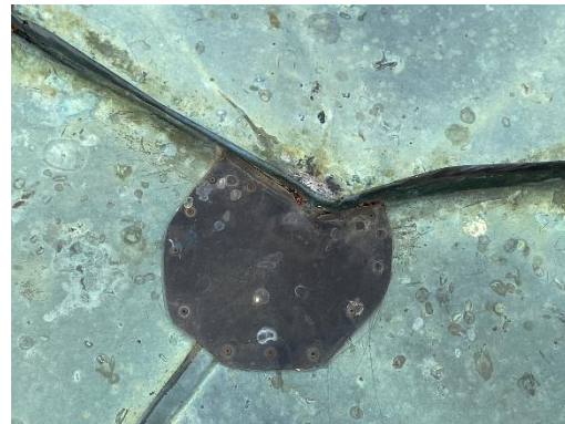
Kuva 33. Kuparikatetta on paikattu epäjalommalla metallipaikalla
