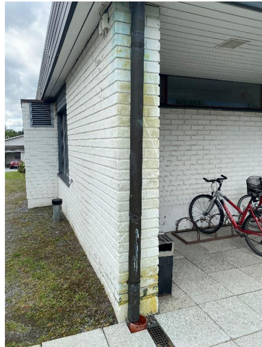
Kuva 8. Rakennuksen päädyssä oleva tiiliseinä on värjäytynyt kuparipitoisen sadeveden seurauksena
