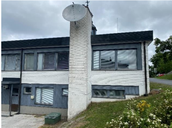
Kuva 11. Rakennuksen nurkalla maanpinta viettää voimakkaasti kohti sisäänkäyntiä
