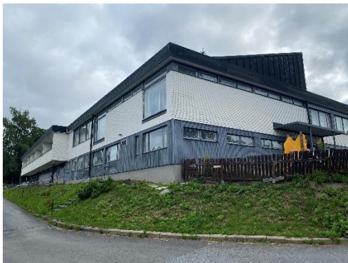
Kuva 13. Seurakuntasalin päädyssä maanpinta viettää voimakkaasti pois päin rakennuksesta
