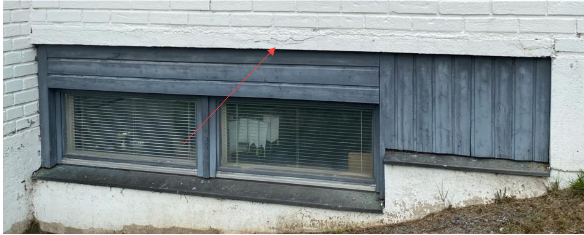
Kuva 19. Halkeama ikkunanylityspalkissa, mikä viittaa edenneeseen korroosioon ikkunanylityspalkin raudotteissa.
