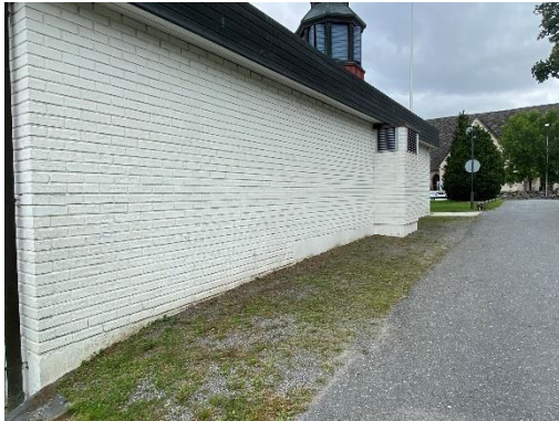
Kuva 9. Idän puolella maanpinta rakennuksen vierellä viettää takapihaa kohti
