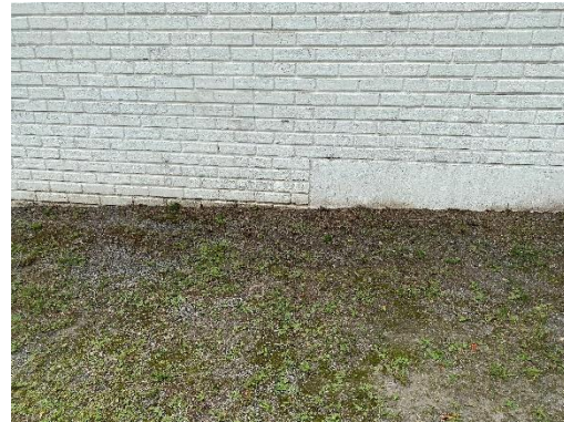
Kuva 10. Itäjulkisivulla alin tiilirivi on paikoin maanpinnan tasossa
